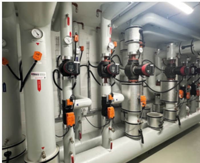
Energieeffizienz bis ins Detail: Die modernisierte Wärmeverteilung ist eine von zahlreichen Massnahmen, mit denen der Energieverbrauch kontinuierlich optimiert wurde.
