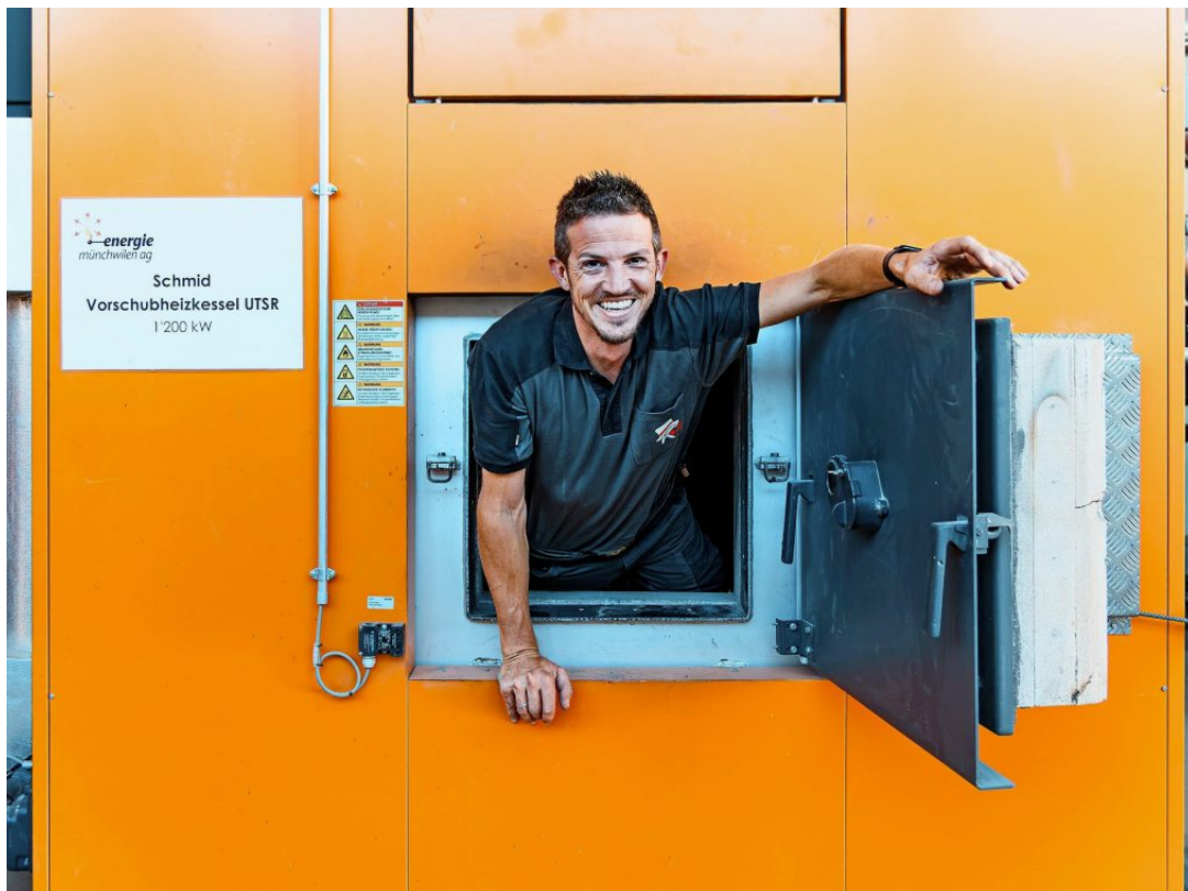
Voller Körpereinsatz. Die Heizkessel kennt Manuel Bachmann in- und auswendig.
